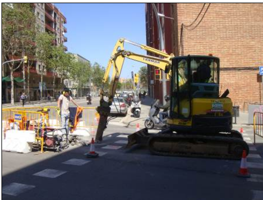
Imatge 6: Vista del carrer del Segre cruïlla amb carrer Sant Adrià, picant el paviment de la Rasa 3.
